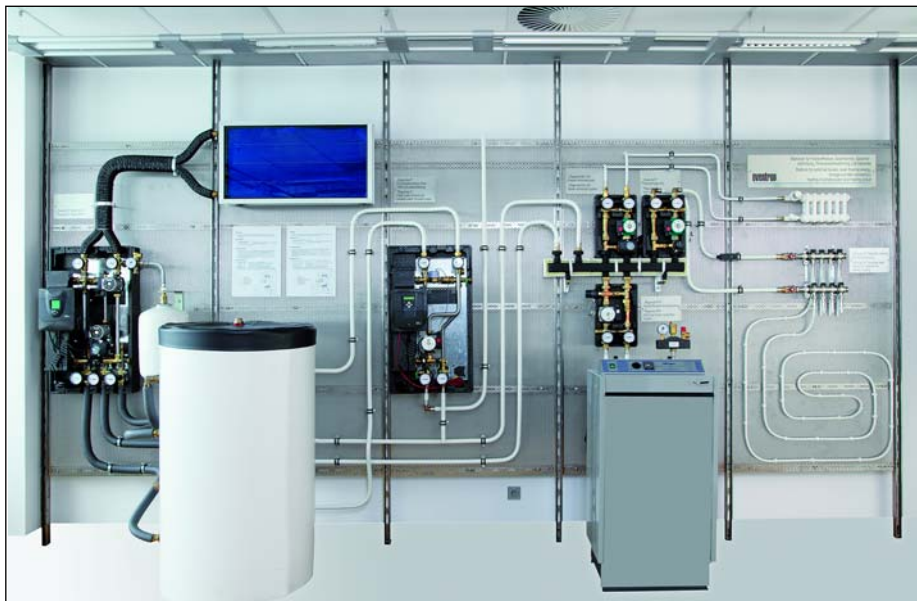
Рис. 2. Пример котельной с накопительным баком и насосной станцией геолоустановки
